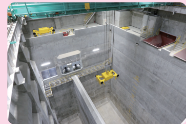
ごみピット・ごみクレーン
